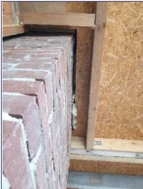
figuur 8: PUR ter plaatse van schoorsteen
