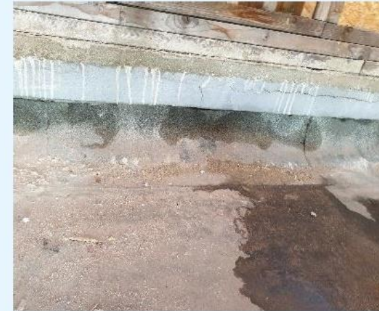
figuur 5: Lekkage aan binnenzijde tussen oude dakrand en betonnen balk (nu de onderzijde van de spouwmuur van de dakopbouw)
