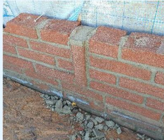
figuur 4: Nieuwe metselwerk op bestaande gevel, zonder open stootvoegen of ontwatering
