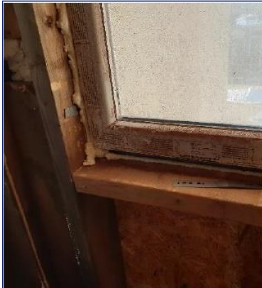
figuur 18: Binnenaanzicht van kozijn, er is geen waterkerende folie zichtbaar welke naar binnen is gevouwen.
